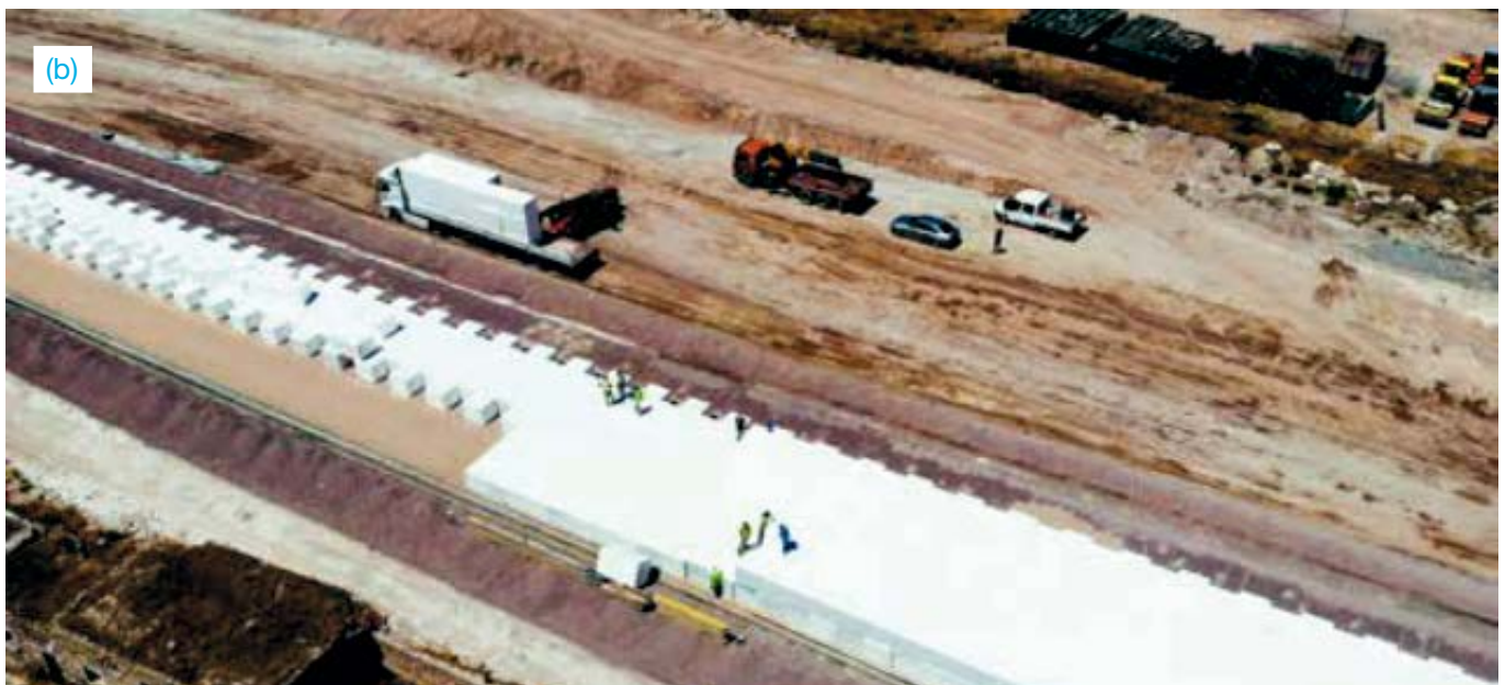
Obrázek 22: Přeprava gefoamových bloků: (a) První bloky GEOFOAM dorazily na staveniště, (b) Průběžná přeprava bloků při pokračující pokládce bloků. (Místo: Bogazkopru-Kocasinan/Kayseri, Turecko, Datum: 02.08. 2019 - 08.08.2019)
